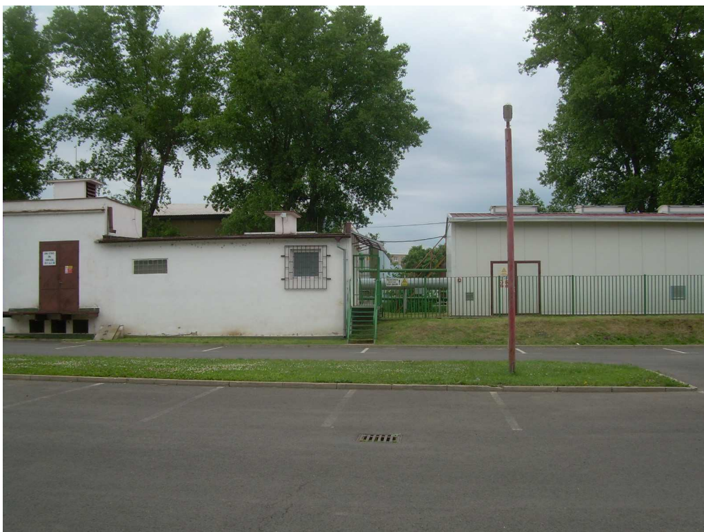
Trafostanice, čpavkové hospodářství
